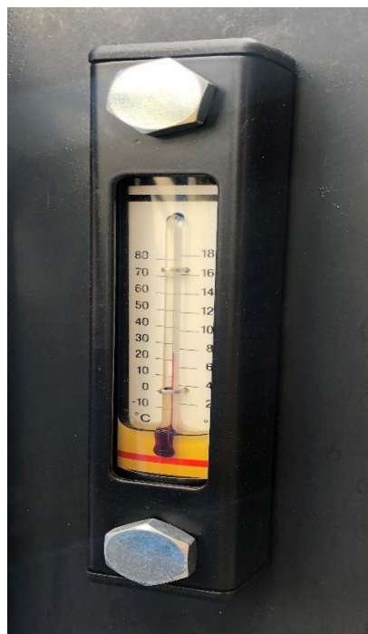
Rys. 7 Kontrola poziomu oleju.
